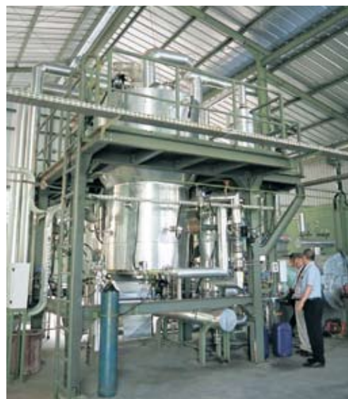
写真2 2トン/日 バイオマスガス化プラント
